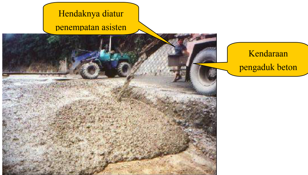
Gambar 2.1 Pada sekeliling kendaraan pengaduk beton perlu dipasang pagar pembatas terpisah, pada saat bergerak mundur hendaknya ada asisten yang memberikan bantuan.
