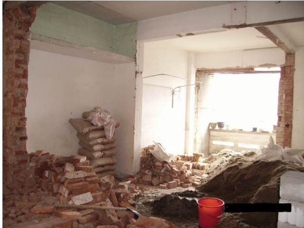
Gambar 2.5 Dinding yang runtuh, bangunan yang mudah runtuh harus dilengkapi dengan tanda-tanda dan pagar pengaman, seperti gambar 2.4.
