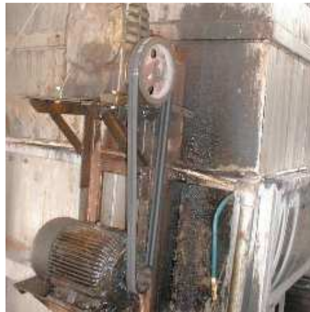
Tidak Ada Pelindung
